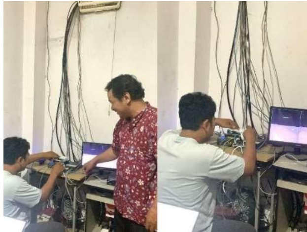
Gambar 6. Pemasangan dan Konfigurasi Mikrotik pada ruang server di Lab
